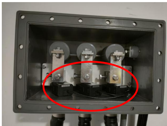
环流监测模块现场安装图
